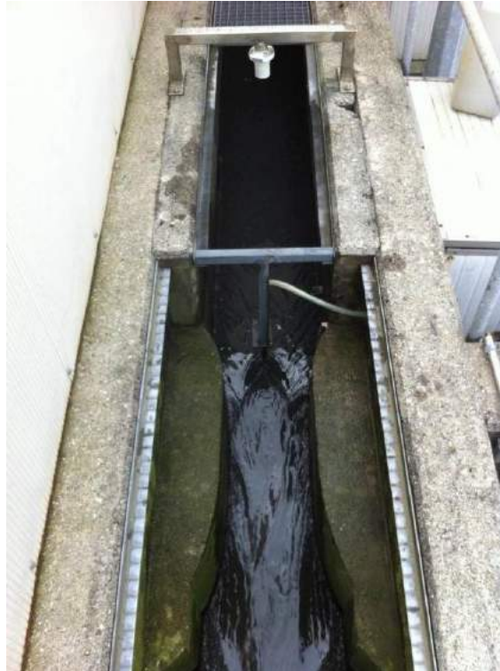
Figure 6 : Débitmètre Venturi entrée STEP Collombey-Muraz
