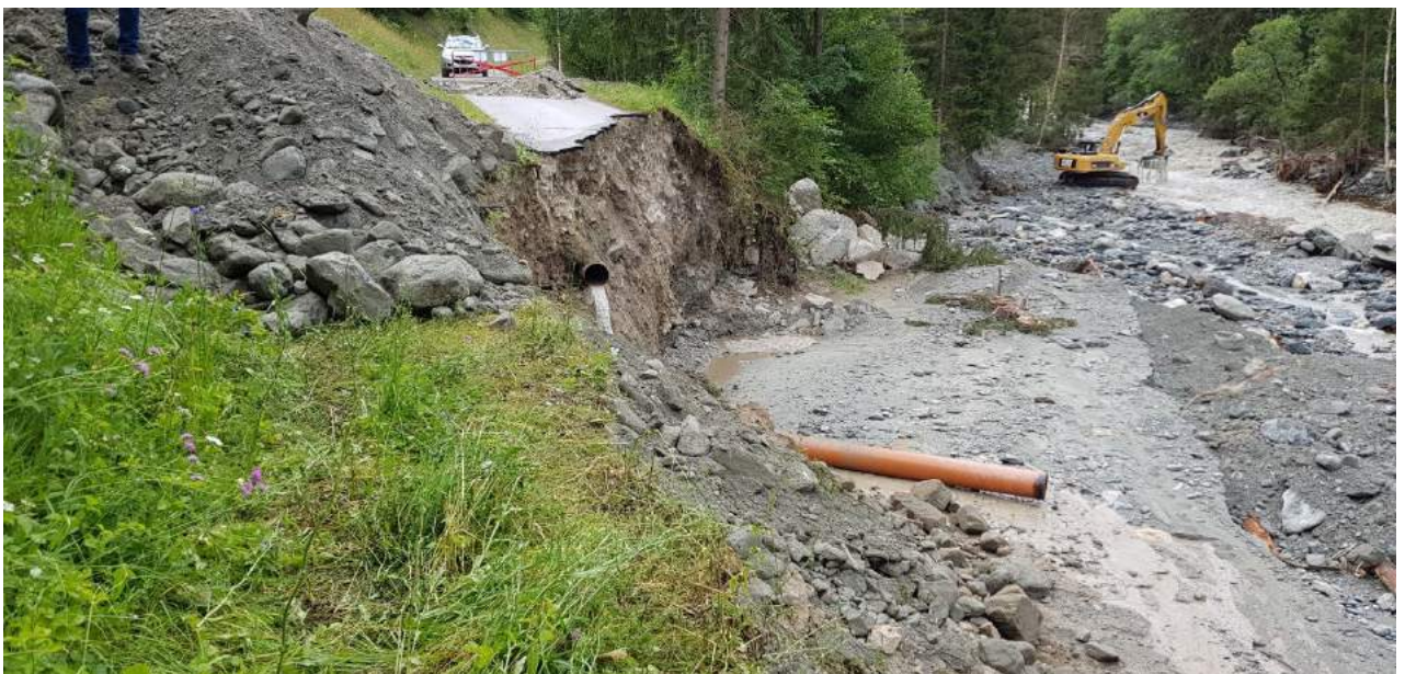
Figure 4 : Val d'Anniviers – dégâts dus à la crue de la Navisence le 2 juillet 2018
