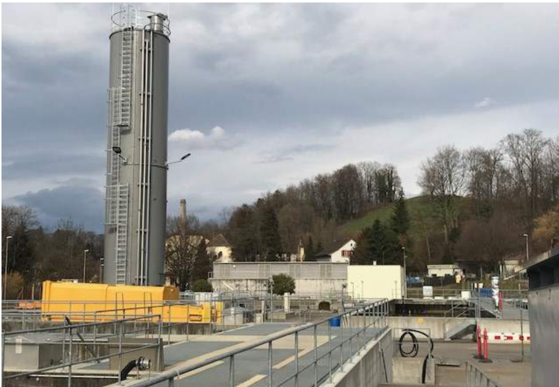
Figure 20 : Exemple de STEP (Wetzikon 37'500 EH) avec dosage direct de charbon actif en poudre (CAP) dans la biologie ; à gauche le silo de de stockage de CAP (100 m 3 )
