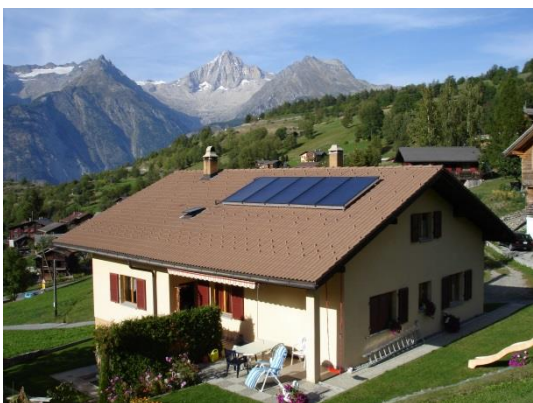
Illustration 4 : installation solaire thermique sur toit en pente, qui ne dépasse pas les pans du toit de plus de 20 cm et remplit ainsi les exigences de l'art. 32a, al. 1, OAT. © Vescal / Walter Meier
