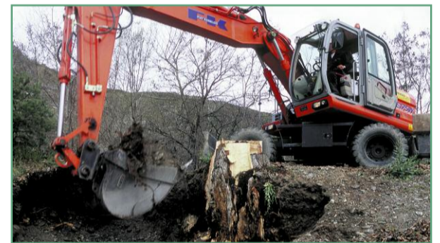
Sanierung der Rhoneufer in Sitten, auf dem Abschnitt des Stadtteils Vissigen. April 2007.
