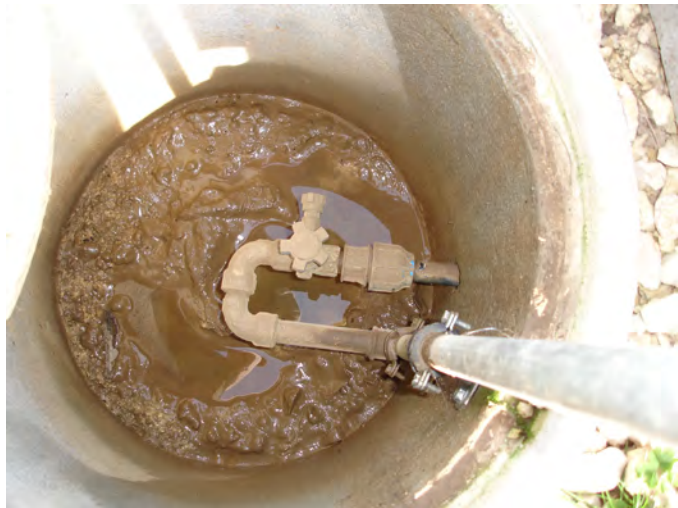
Chambre de raccord avec vidange et vanne
