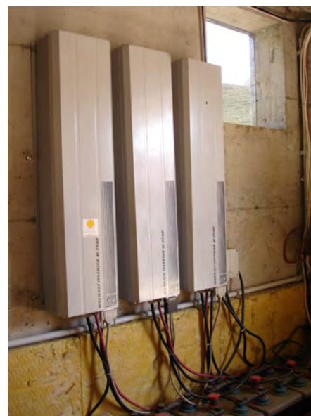
Onduleurs et batteries
