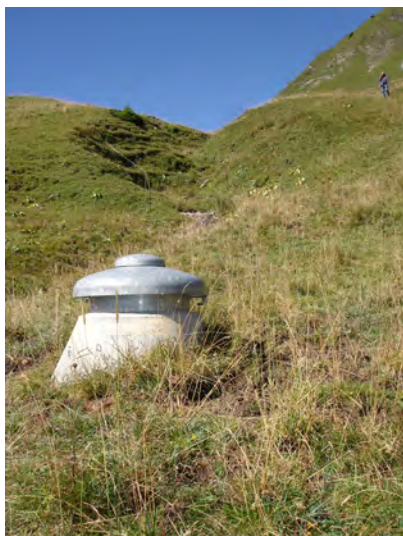
Regard de chambre d'eau
