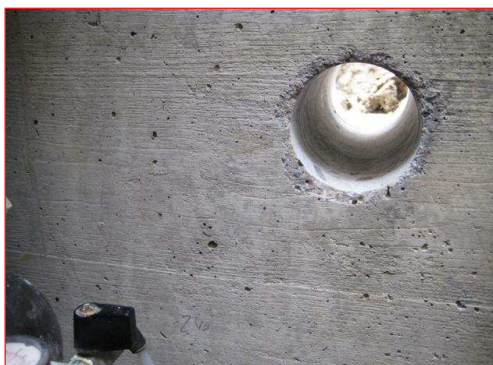
Durchlöcherter Mauer im Reservoir
