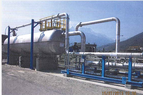
Séparateur eaux-hydrocarbures pour les eaux des bassins
