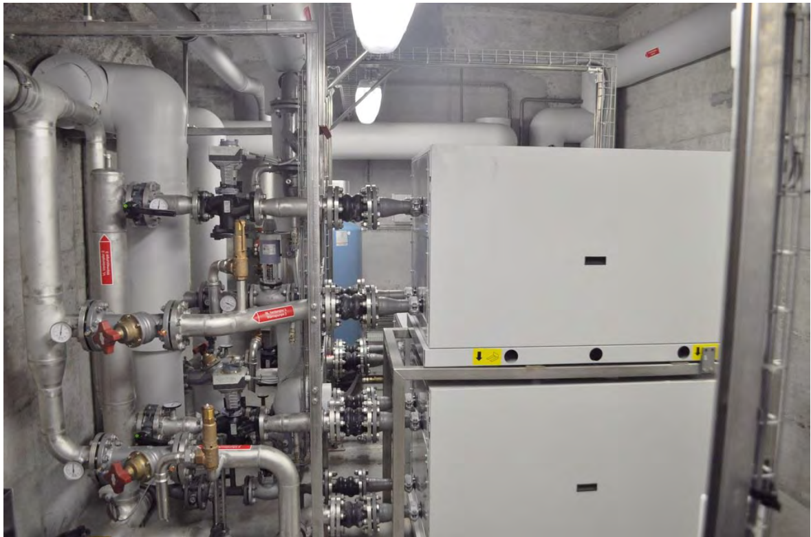
Abb. 22: Abwasserwärmenutzung im Ablauf der ARA Zermatt
