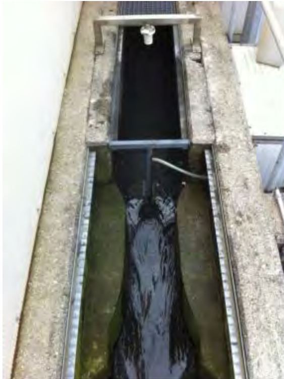
Abb. 8 : Venturi Durchflussmessung Zulauf ARA Collombey-Muraz
