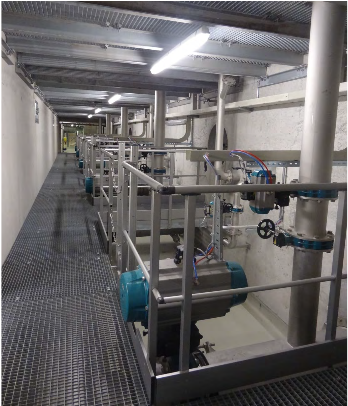
Abb. 13 : ARA Bagnes-Le Châble : Biofilter zur Nitrifikation
