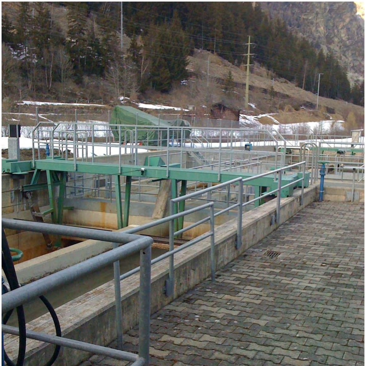
Abb. 12 : ARA St-Niklaus: die betroffene Industrie hat eine Vorbehandlungsanlage in Betrieb genommen um die DOC-Frachten zu reduzieren; starkbelastete Abwässer werden extern gesetzeskonform entsorgt.
