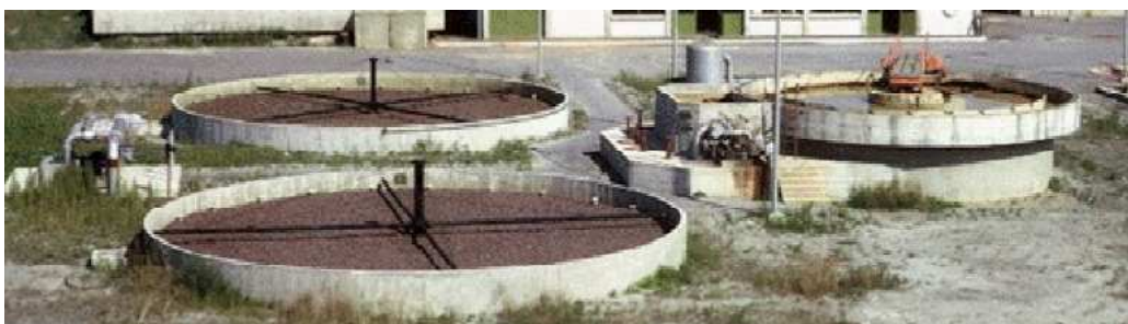
Abb. 10: ARA Collombey-Tamoil: zwei Tropfkörper gefüllt mit Puzzolane
