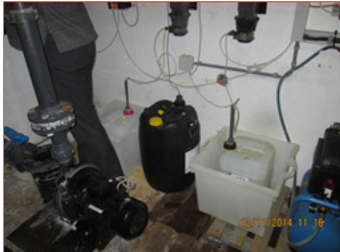
Dieselbe Anlage nach ihrer Sanierung. Es fehlt immer noch ein Auffangbecken unter dem Kanister (schwarz) mit dem Bleichmittel
