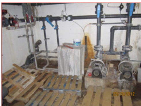
Veraltete und schlecht gewartete Desinfektionsanlage
