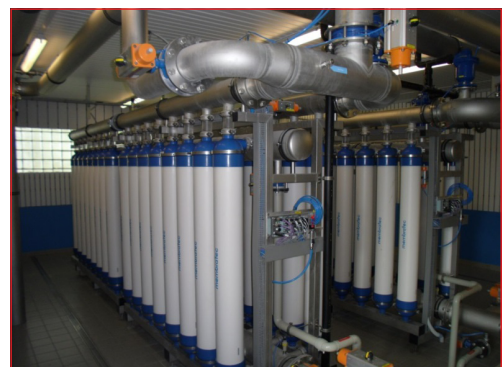
Wasserbehandlung mittels Ultrafiltration
