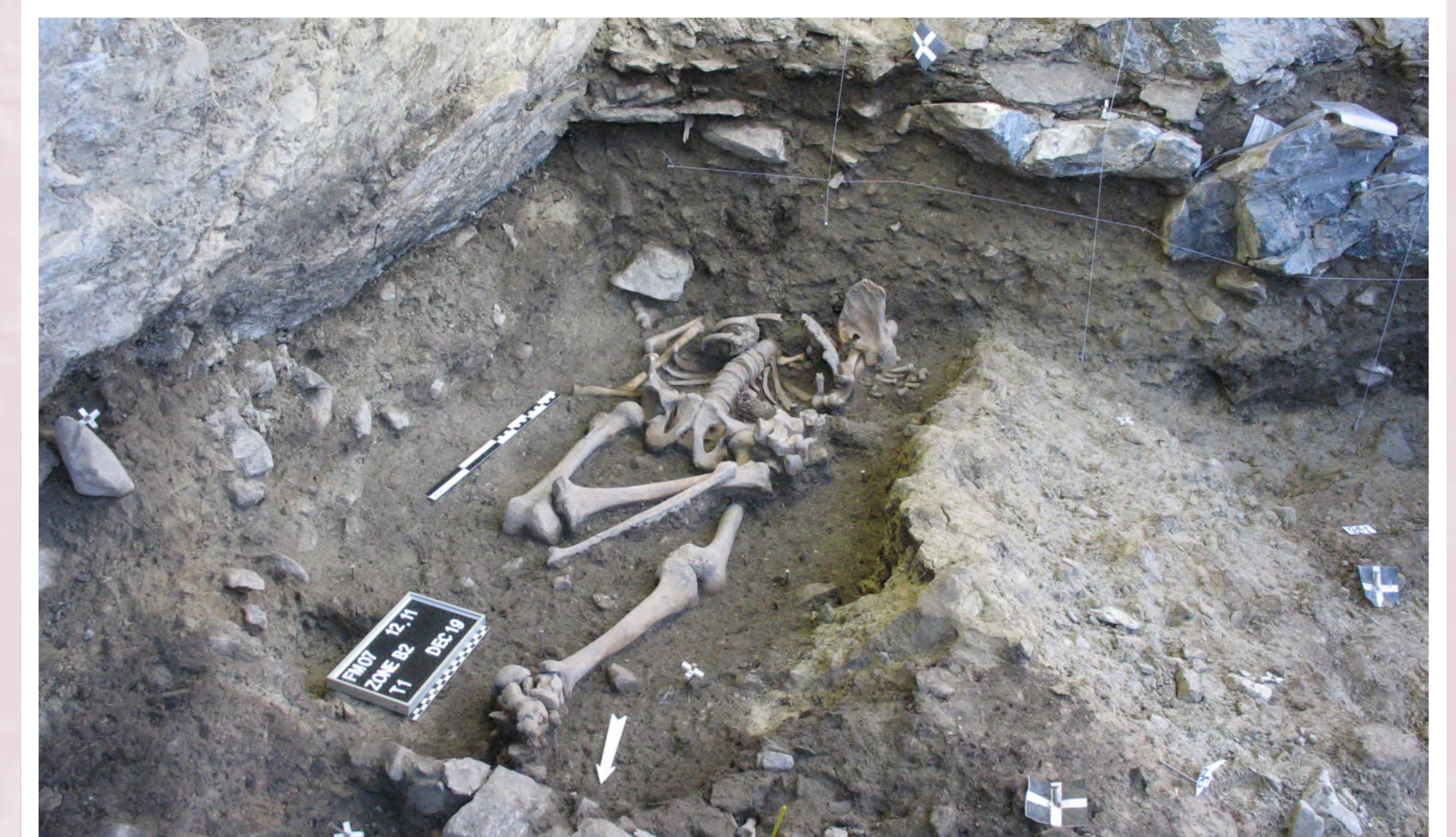
Frühmittelalterliches Grab, das nur teilweise ausgegraben wurde, da in der Nähe die Gasleitung auf der Höhe des Schädels der Bestattung verlief. © ARIA SA / OCA.
