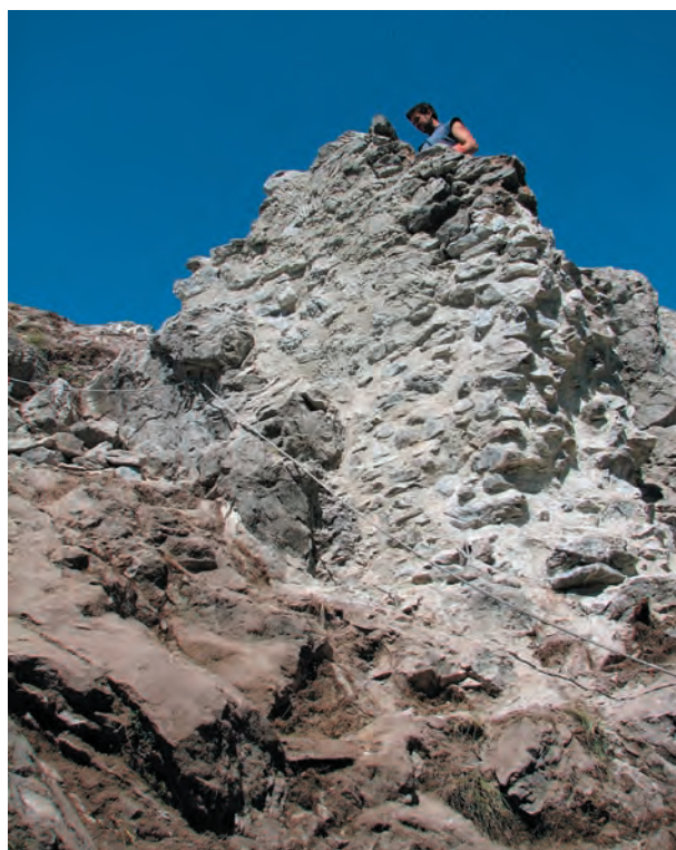
Fig. 9 ... et après sa consolidation (dans la partie supérieure, les travaux sont encore en cours). Vues du sud-est.
