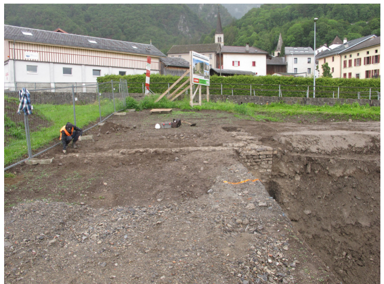
Fig.14 – L'angle nord du bâtiment B1 est conservé sur une hauteur de 2,20 m. Vue en direction du sud.
