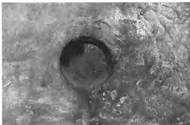
Fig. 56. Estavayer-le-Lac FR, Rue du Musée 12. Premier étage, pot inclus dans le mur est. Photo SAEF, G. Bourgarel.
