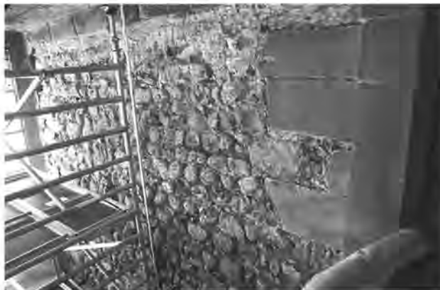
Abb. 53. Zug ZG, Kolinplatz 12, Zitturm. Blick von der Altstadt in die Tordurchfahrt Richtung Norden. Das äusserst regelmässige, originale Mauerwerk der Zeit um 1300 ist brandversehrt. Die Sandsteinquader vorne links bilden den inneren Torbogen und stammen von 1480. Foto KA ZG, M. Bolli.
