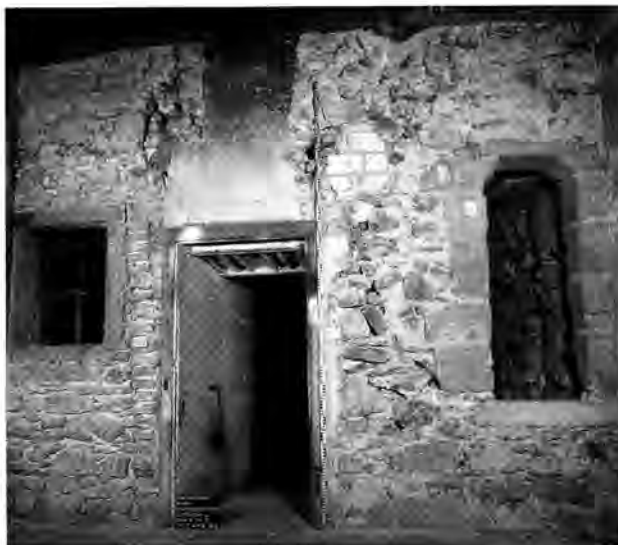
Abb. 33. Bern BE, Brunnngasse 56. Blick auf die Nordseite der Stadtmauer mit jüngeren Durchbrüchen und Unterfangungen. Rechts die Kragsturztür des 13. Jh. Photo ADB, D. Kissling.
