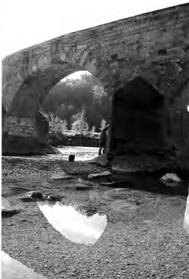
Abb. 34. Bischofszell TG, Thurbrücke. Beginn der Renovationsarbeiten an der im späteren 15. Jh. errichteten Steinbrücke. Photo Amt für Archäologie TG.
