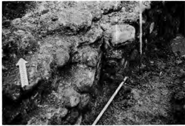
Fig. 55. Nyon VD, La Morache. Bâtiment B: réfection avec trace d'un étayage dans le mur sud de S2 (fig. 52, 3).
