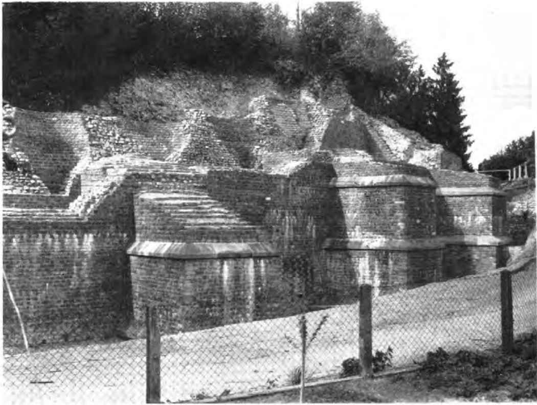
Tafel X, Abb. 1. Augst. Theater, Strebepfeiler an der südlichen Peripheriemauer. 1946/47 konserviert (S. 66)
