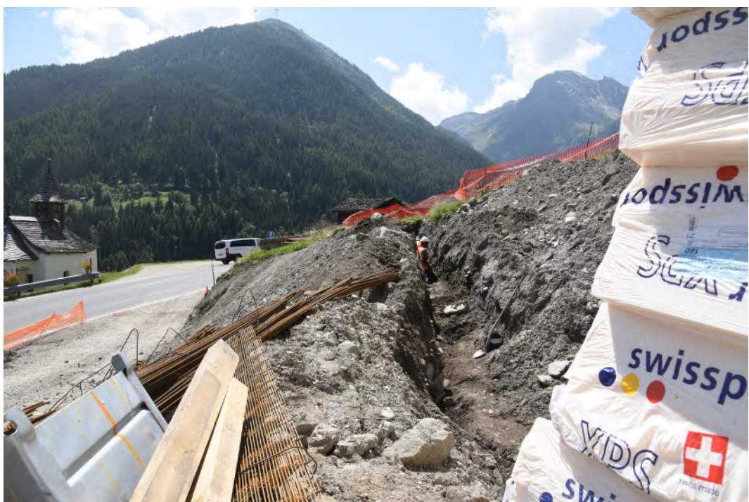
Fig. 4 – Grimentz, les Gères. En juillet 2021, la tranchée Tr. 7 a été creusée environ 2 m au-dessus du site. Vue du nord.
