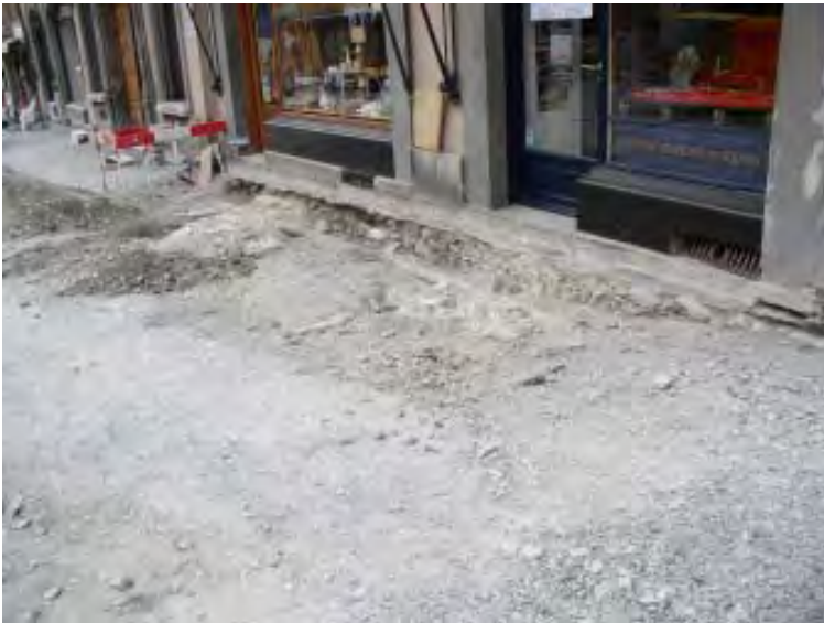
Fig. 33 Rue du Grand-Pont n° 17. La façade du bâtiment actuel est posée sur l'extrados de deux voûtes qui recouvrent les caves d'un édifice plus ancien. Vue depuis le nord.
