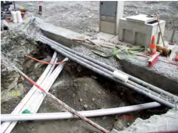
Fig. 37 Rue du Grand-Pont, au sud du débouché de la rue de Conthey. Maçonneries UT27 et UT28, vues depuis le sud-ouest. Cette image illustre de manière symptomatique les difficultés que nous avons rencontrées sur le terrain, notamment l'étroitesse et la faible profondeur des sondages et la présence de conduites de toutes sortes et époques.
