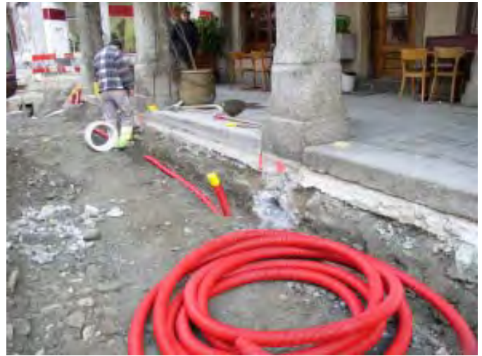
Fig. 30 Rue du Grand-Pont. Sous la galerie de la Grenette, apparaît le parement du mur plus ancien (UT29). Vue depuis le sud-ouest.
