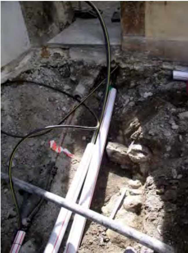
Fig. 21 Rue du Grand-Pont. Le mur UT34 percé par les canalisations, vue depuis le nord.
