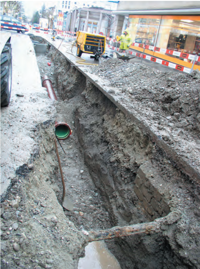
Fig. 25 Rue de Lausanne. Tranchée au nord du bâtiment de l'édilité (n° 23), profil nord vu de l'est. Au fond du profil, les alluvions compactes et argileuses de la Sionne recouvertes par les remblais des conduites modernes. Le mur d'enceinte n'était plus conservé.
