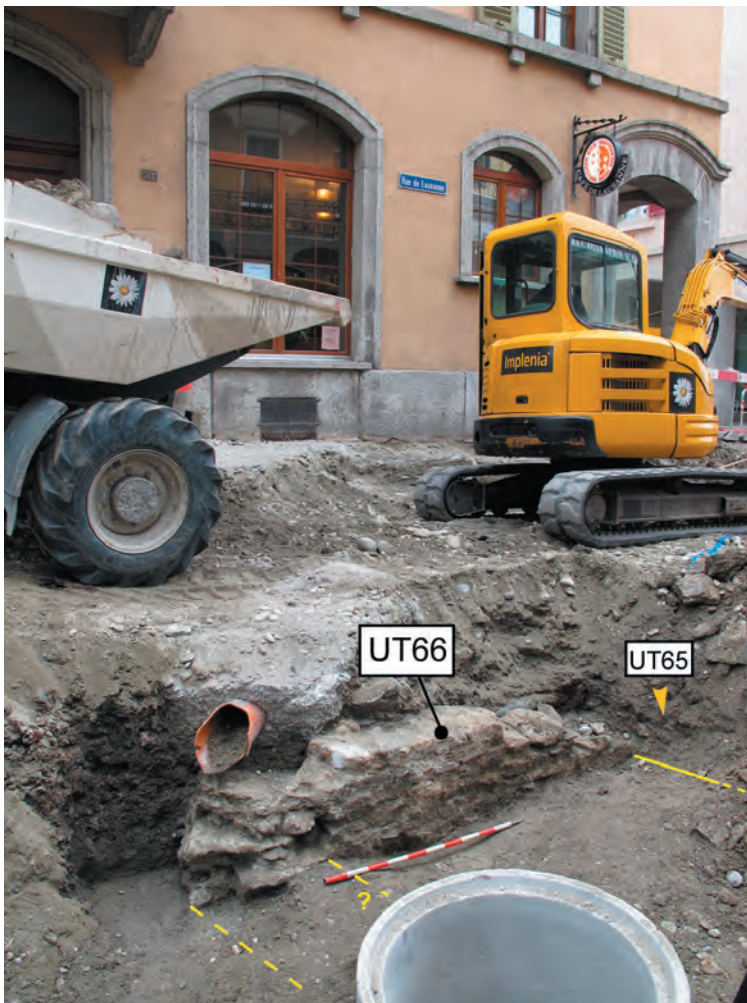
Fig. 34 Rue de Lausanne. Tranchée au nord du Café de Lausanne (n° 21), profil sud vu du nord-est. Mur sud (M66) d'un édifice semi enterré (cave) situé dans le périmètre d'un ancien jardin (Esp.2). Le retour occidental du mur (M65) est encore caché par les remblais.
