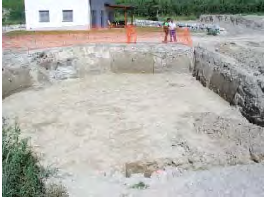
Fig. 6. Bramois / Chantier Chevrier. Vue générale de la parcelle n° 16343 depuis l'ouest. A gauche, au centre et à droite : les tronçons de profils nettoyés sur env. 3.00 m de longueur. Le niveau empierré se situe env. 0,20 m au-dessus du fond de fouille. Au bas de l'image : le bord du sondage.
