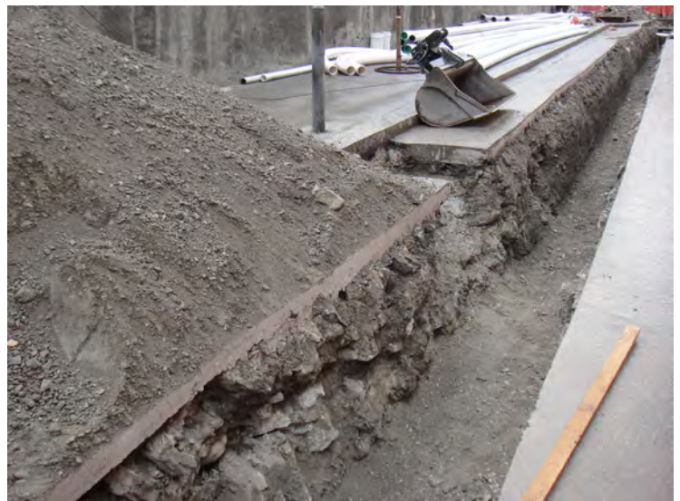
Fig. 12 Rue de Savièse ; tranchée en amont de la maison n°28 (profil ouest, vu vers le nord). Au premier plan, les fondations du Bâtiment 1 (avant nettoyage) ; à droite, la zone de jardins qui borde l'ancienne ruelle longeant les remparts.
