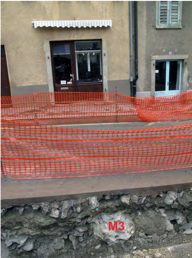
Fig. 16 Rue de Savièse ; tranchée à la hauteur de la maison nos 26-24 (profil est) : mur M3, un mur de refend du Bâtiment 2 ?
