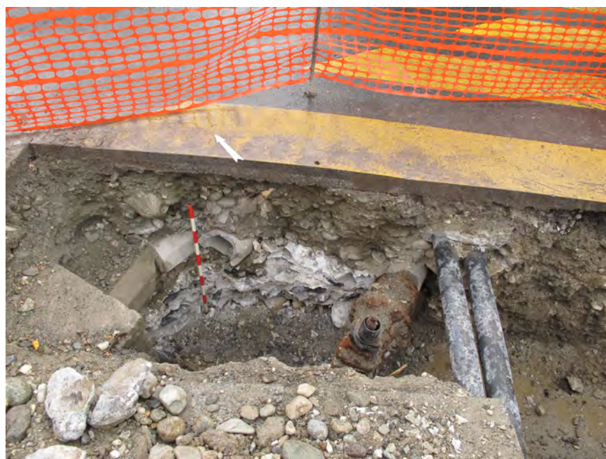
Fig. 9 Rue de Savièse ; extrémité nord de la tranchée. Maçonnerie de l'enceinte médiévale de la ville (M70) perturbée par les canalisations modernes.
