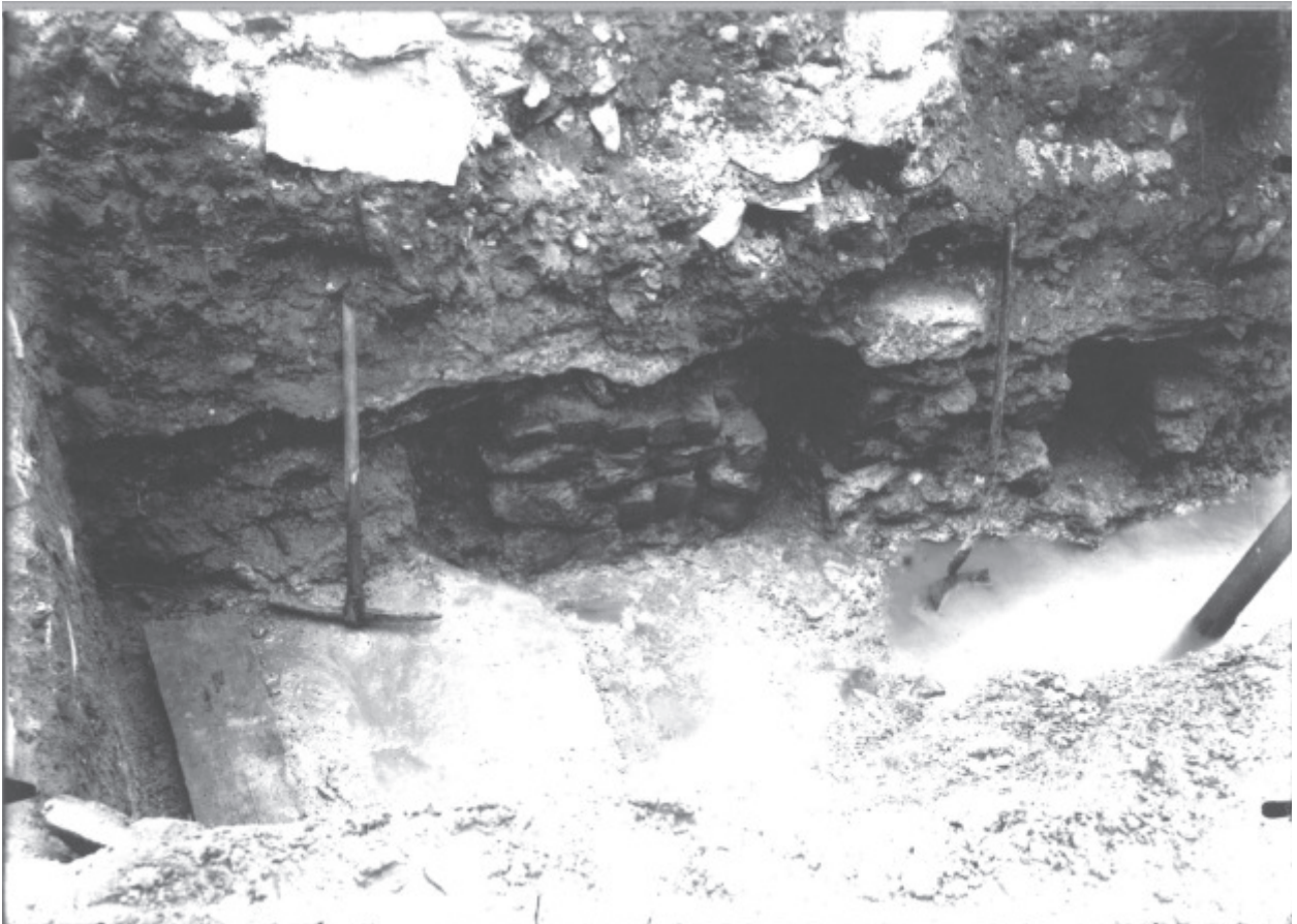
Fig. 5. St-Maurice, avenue d'Agaune. Photographie prise durant les travaux de pose du collecteur d'égout en 1911. La situation de la vue n'est pas précisée. En revanche, l'image rappelle les socles portant le dernier sol de l' aula . Le Chanoine Bourban les avait donc observés. Il les a et interprétés comme «pavés et égouts romains» (inscription au dos de la photo).
