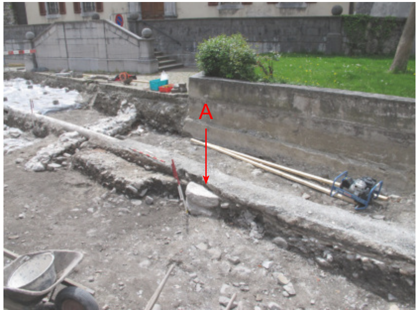
Fig. 73. St-Maurice, avenue d'Agaune. Maison abbatiale 1, phase 5. A: base de pilier central du local. Vue depuis le nord-est.
