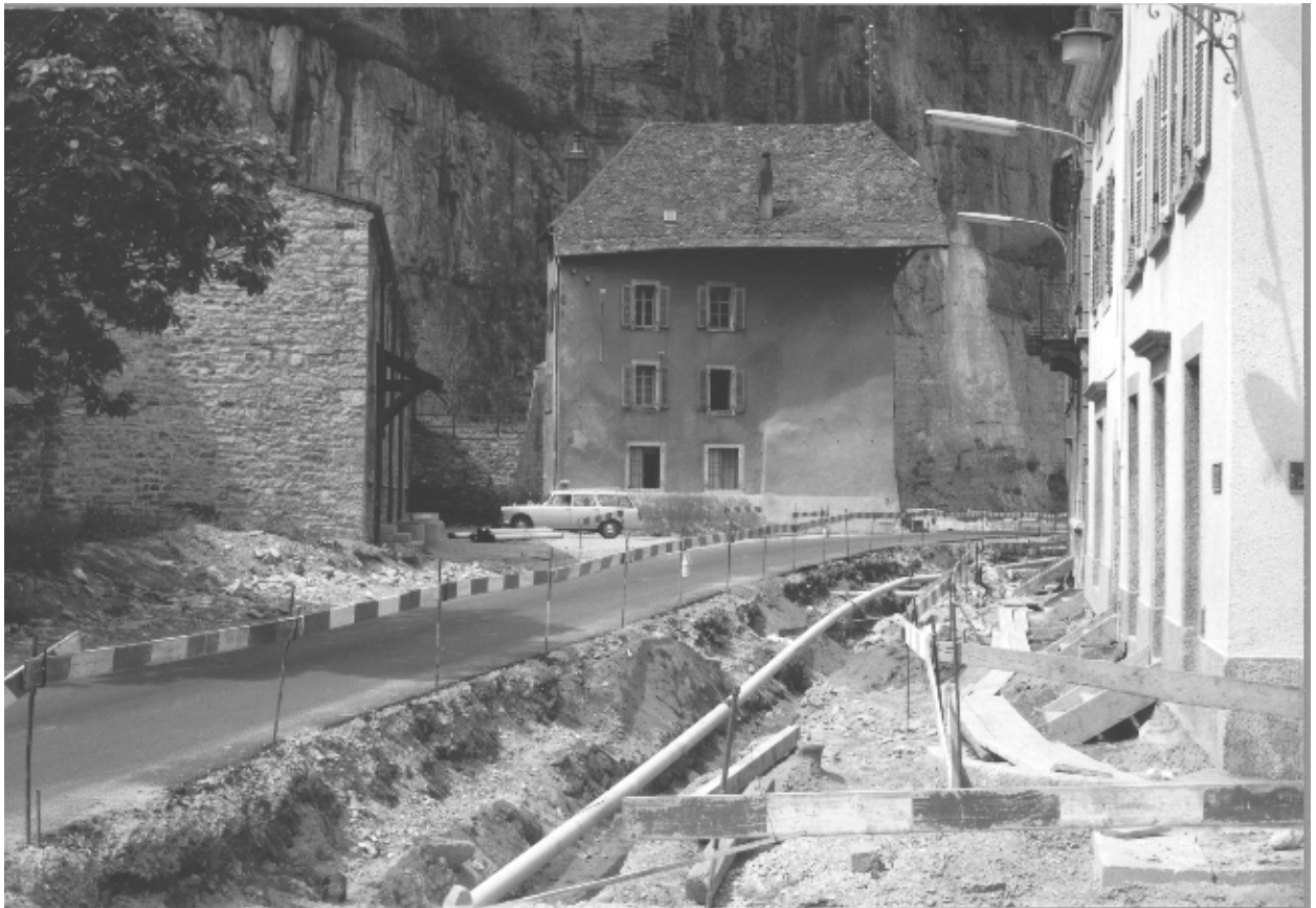
Fig. 8. St-Maurice, avenue d'Agaune. Vue du chantier de la fin des années 1960 ou début des années 1970, pour l'implantation de nouvelles conduites, en face de l'entrée de l'abbaye, près de la maison Monnay (à droite). Vue depuis le sud.
