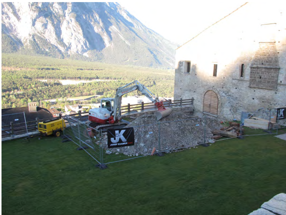
Fig. 2. Leuk-Stadt, Turmmatte. Vue générale du chantier, depuis le nord-est (depuis la terrasse du parking).
