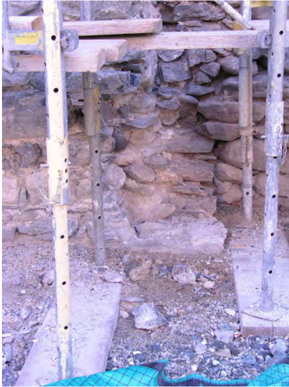
Fig. 8 Façade Ouest. L'angle Sud-Ouest de la première maçonnerie (23) a été cassé avant la construction du rez avec la maçonnerie (38) du corps Central (à droite) et la maçonnerie (25) du corps Ouest (à gauche).
