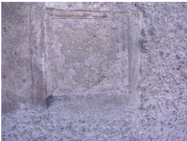
Fig. 21 Façade Nord. Plaque de marbre (31) portant une inscription difficilement lisible (écusson et la date 16 19 (1619?)). Son insertion perce le contrecœur de la fenêtre (39), mais précède la pose du crépi gris à carreaux. A droite, restes d'un crépi grossier plus récent.
