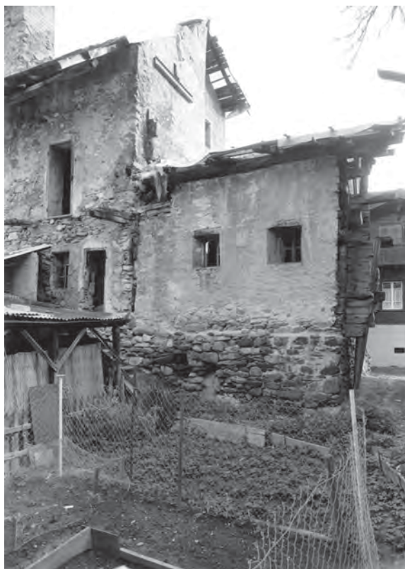
Fig. 28 Vue avant le début des travaux : façade Ouest du corps Sud (photo Monuments Historiques).
