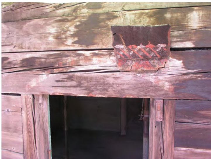
Fig. 18 Façade Ouest. Détails du décors du chalet construit au milieu du XIXe siècle (68). On remarque la tête de sablière plus récente qui abîme le décor d'origine (arc en demi centre) mais qui a elle-même été peinte tout en imitant le motif ancien.
