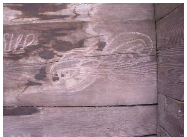
Fig. 15 Façade Nord. Détails du décors du chalet construit au milieu du XIXe siècle (68).
