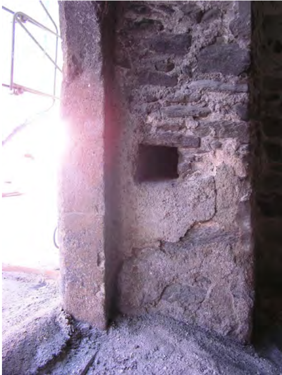
Fig. 19 Passage voûté au rez, portail Nord (70). La glissière horizontale (72) aménagée dans le piédroit oriental permettait de ranger la barre qui servait à verrouiller les vantaux de la porte donnant sur la rue.
