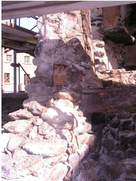
Fig. 3 Détail de la solive (47) qui portait le chalet du corps Sud et dont l'extrémité occidentale était prise dans la maçonnerie (24A).
