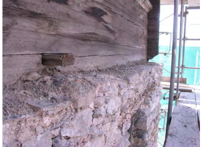
Fig. 13 Façade Nord. Assise de réglage (35) qui sert de support à la panne inférieure du chalet en madrier (68) existant encore aujourd'hui.
