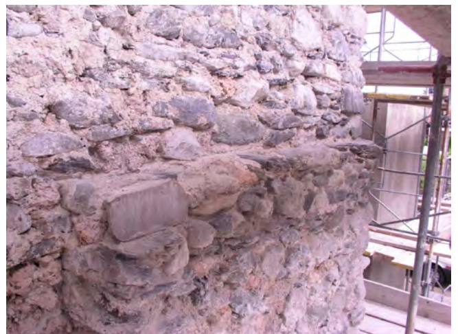
Fig. 4 Façade Sud. Ressaut marquant la limite entre le 1er et le 2e étage de la cage d'escalier. Une chape de mortier lissé et patiné recouvre le couronnement du mur inférieur (2).
