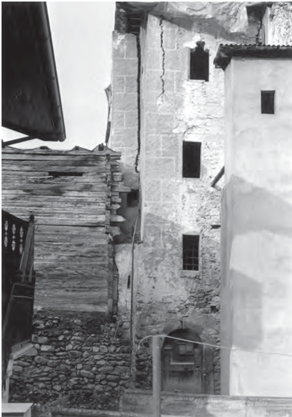
Fig. 32 Vue avant le début des travaux : façade Est, détail de la cage d'escalier. (photo Monuments Historiques).
