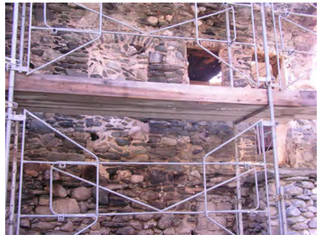
Fig. 22 Façade Ouest, 1er étage. La porte (20) (à gauche) donnant accès au balcon est bouchée et remplacée par la porte (60) (à droite) lors d'une modification récente.
