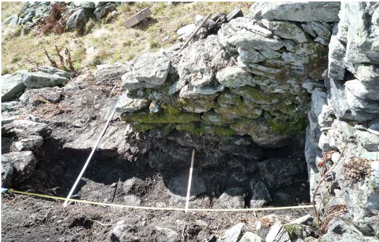
Fig. 4. Bagnes, Les Shlenandes. Décapage 2 dans l'angle d'un bâtiment, au niveau du sol de la dernière occupation du bâtiment (dallage peu soigné) ; à gauche, le seuil d'entrée.
