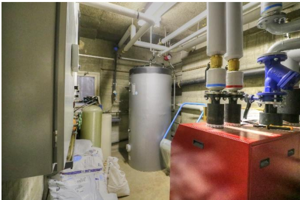
Local technique avec chauffage à distance
