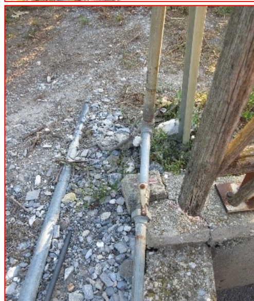
13 : Conduites de raccordement du système d'irrigation d'eau potable. © SCAV
