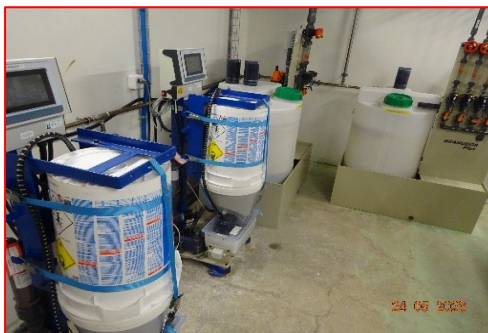
14 : Système de désinfection à l'hypochlorite de calcium. © SCAV
