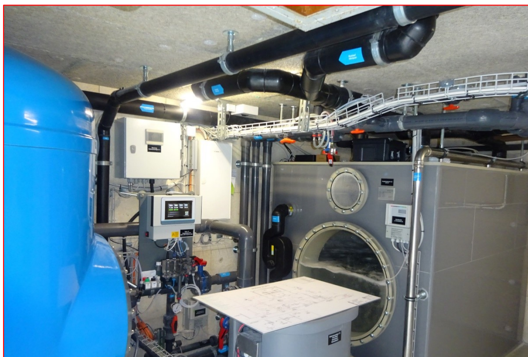
5 : Installations techniques pour les eaux de baignade. © SCAV
