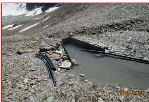
24 : Captage d'eau. © SCAV
