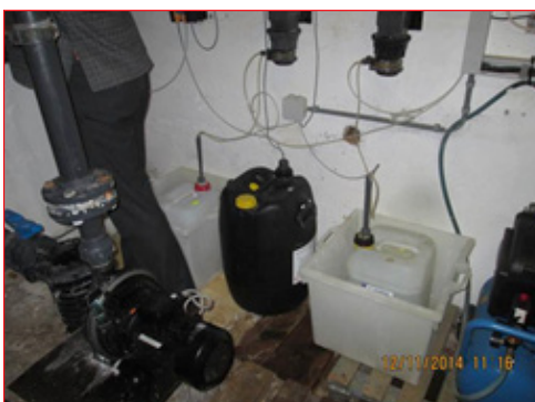
La même installation assainie où il manque toujours un bac sous le bidon (noir) d'eau de javel
