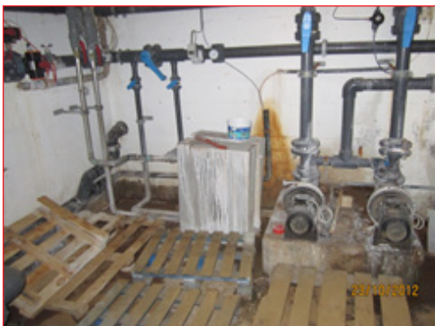
Installation de désinfection vétuste et mal entretenue
