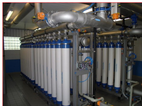
Traitement de l'eau par ultrafiltration
