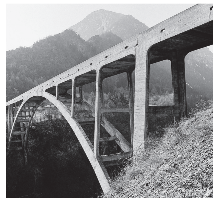
Gueuroz. Die Brücke von Gueuroz (Alexandre Sarrasin, 1934) über die Trient-Schlucht markiert den Höhepunkt der Bogenbrücken dieses Ingenieurs. Die zwei parallelen Bögen mit einer Öffnung von 98,5 Metern überragen den Wildbach um 190 Meter.*
