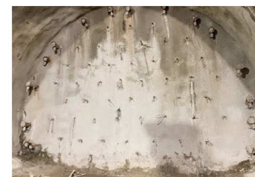
Front Nord à l'arrêt avec clous GFRK sur le front et colonnes de jetting en couronne Nordwand GFRK-Nägeln an der Stirnseite und Spritzsäulen in der Krone
