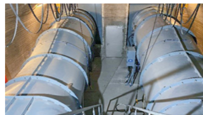
Im Technikraum "Mitte" wurden zwei Abluftventilatoren installiert. Deux ventilateurs d'évacuation ont été installés dans le local technique «Mitte»
