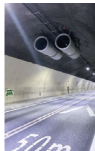
Die Ventilatoren sorgen für die erforderliche Luftqualität im Tunnel. Les ventilateurs garantissent la qualité de l'air requise dans le tunnel
