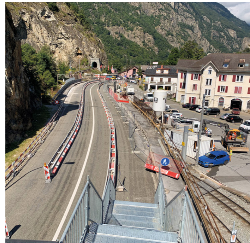
Le pont à la hauteur de la gare de Vernayaz - Die Brücke beim Bahnhof Vernayaz
