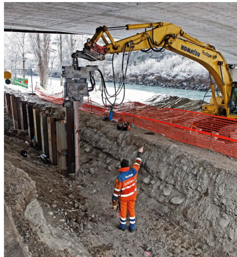
Arrondissement Valais Central : copyright SRTCE
