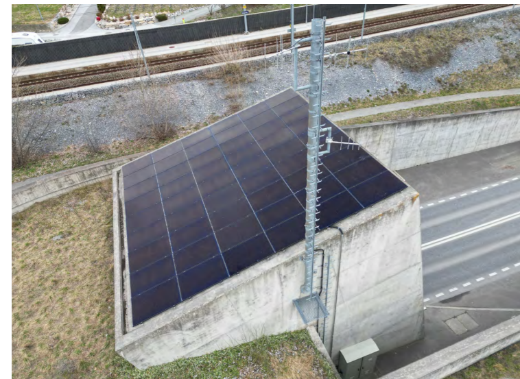
Installation solaire – Tunnel du Hubil | Solaranlage – Hubil-Tunnel
