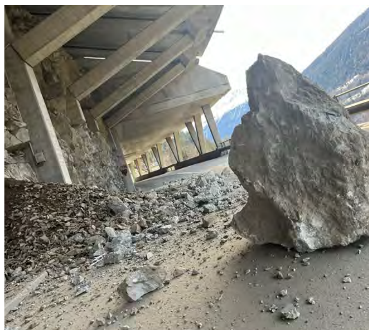
Chute de blocs en Anniviers | Blocksturz in Anniviers
