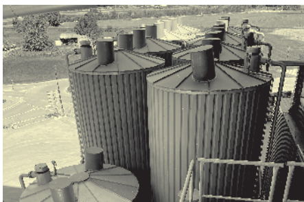
Mit Bitumen gefüllte Silos / Fässer.
