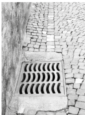
Grille d'évacuation des eaux de pluie
