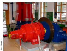
Turbine verticale de type «Pelton», volant d'inertie et générateur
