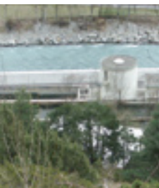
La station d'épuration de Stalden
