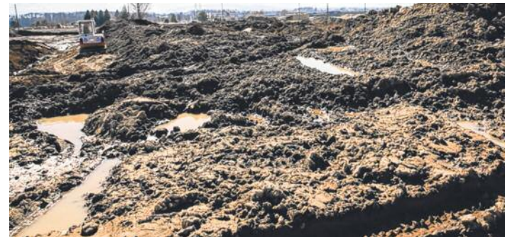
Terrassement en conditions humides pour déverser des matériaux d'excavation de chantier dans un parcelle agricole. Les dégâts sont tels que les atteintes à la fertilité et au potentiel de production sont définitives.
