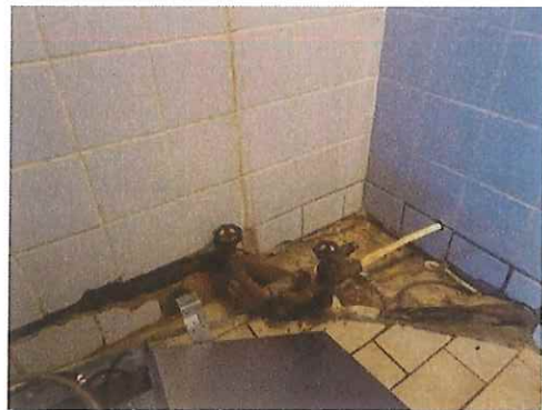
Carrelage endommagé / conduites apparentes (cuisine du bar)
