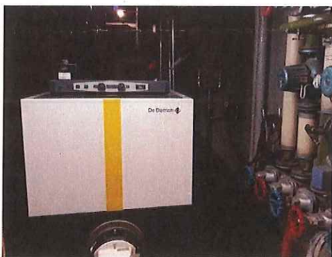
Chaudière à mazout
