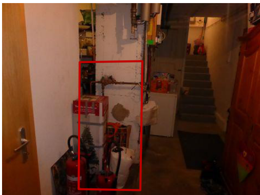
Emplacement chaudière (voir remarque point 8.10)
