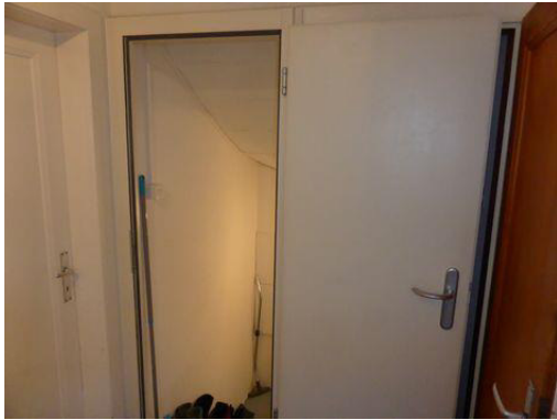
Porte anti-feu | Accès sous-sol
