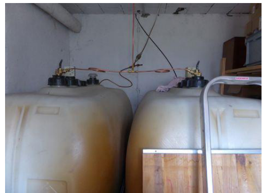
Cuves à mazout (voir remarque point 8.10)
