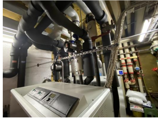
Pompe à chaleur changée en 2012
