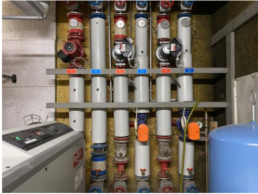
Distribution du chauffage
