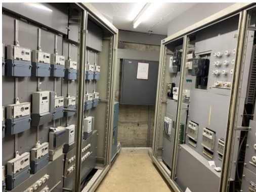
Local électrique – rez-de-chaussée
