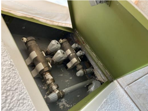
Vannes de chauffage
