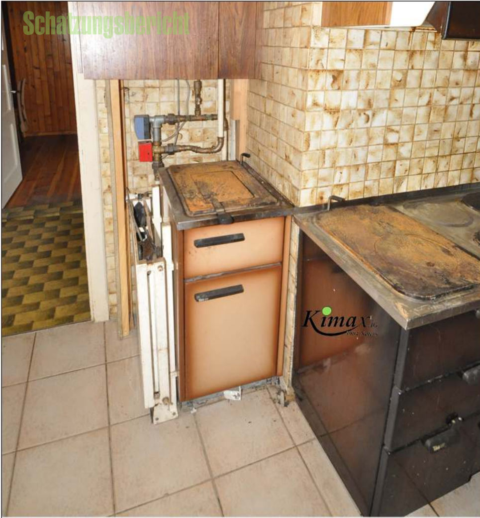
Wohnküche mit Etagenheizung und Holzofen
