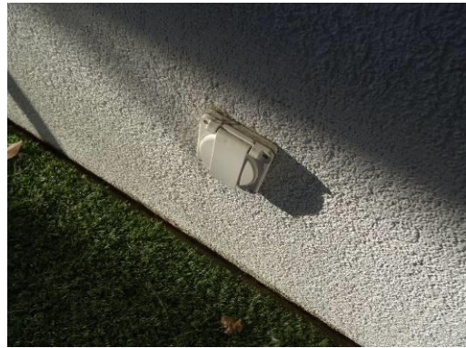
Alimentation électrique extérieure (terrasse)
