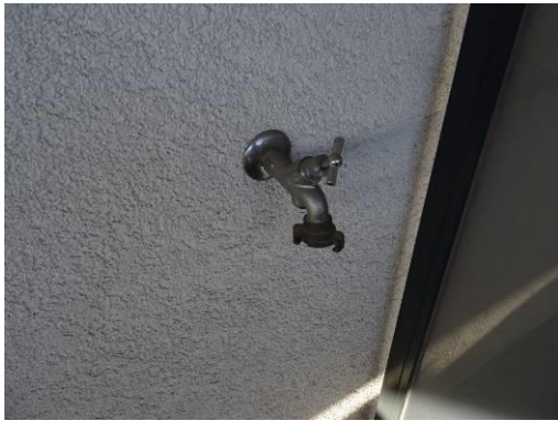
Arrivée d'eau extérieure (terrasse)
