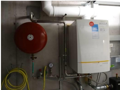
Chaudière à gaz (2012) et vase d'expansion
