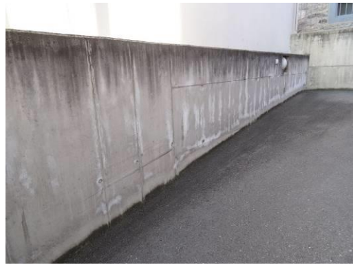
Traces d'efflorescence mur extérieur (rampe de garage)
