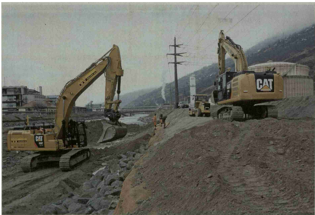
Die laufenden Bauarbeiten zum Schutz der Bevölkerung, der Industrie und der Wohnhäuser, wie hier im Abschnitt Visp, sind möglich dank des vom Volk am 14. Juni 2015 angenommenen Finanzierungsfonds. FOTO KANTON WALLIS
