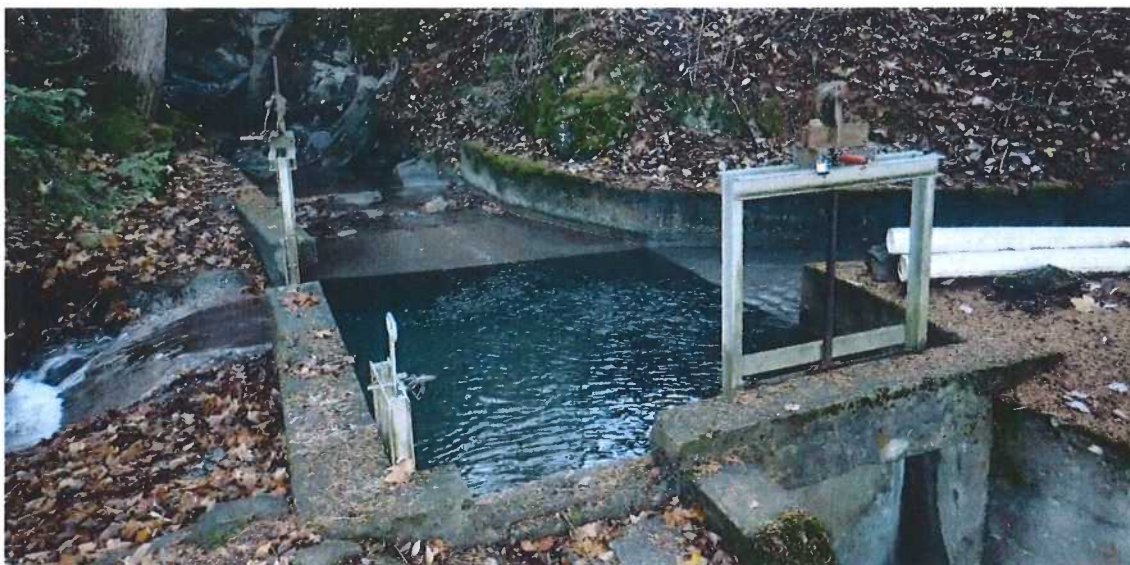
Figure 1 Ouvrage de répartition des débits entre la Monderèche (en haut et à gauche) et le Tsatelar (à droite et en bas). L'intégralité des débits alimentent la Monderèche (30.10.2015).
