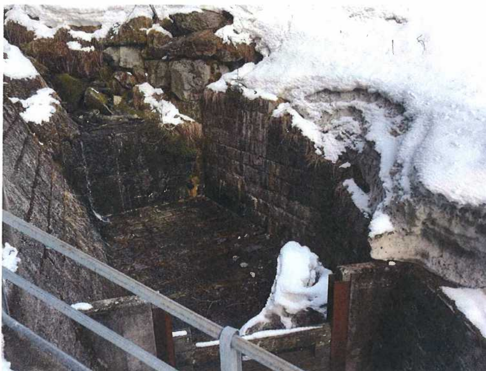
Photo 4-19 Dépotoir au niveau du virage de la Caffé
