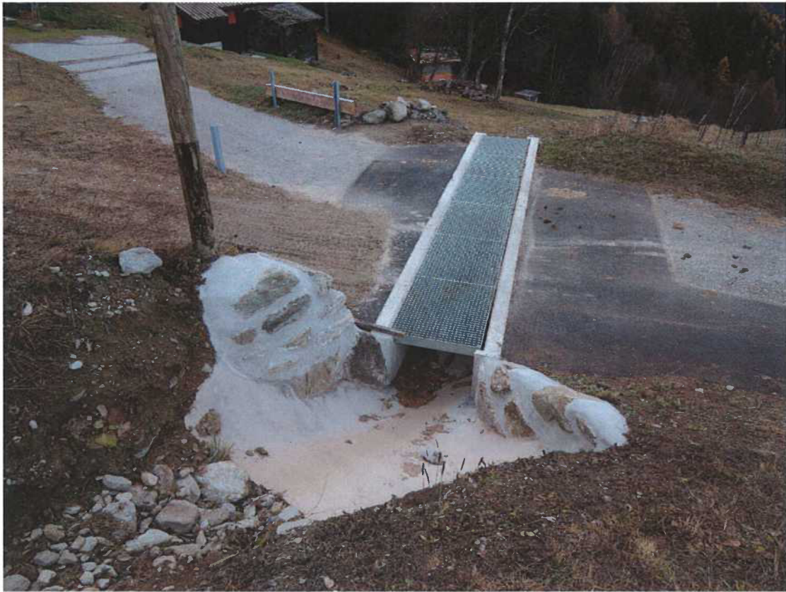
Abbildung 8: Durchlass bei der Strasse kurz vor dem Weiler „Unner Alber,“
