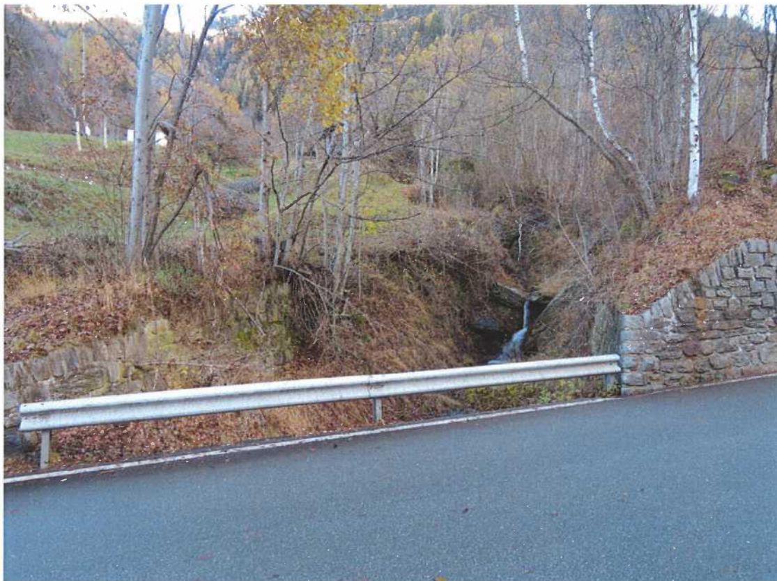
Abbildung 11: Sicht auf das Chummugraben-Gerinne ab der Brücke der Kantonstrasse Turtmann-Oberems.
