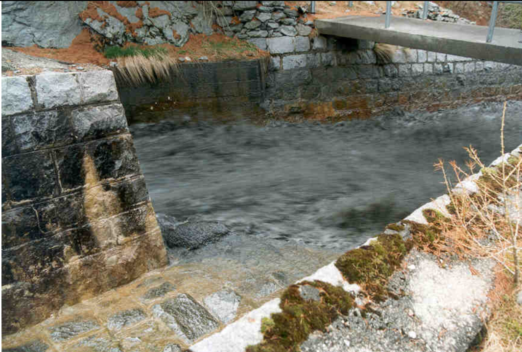
Spülung unterhalb des Ausgleichbeckens Les Esserts
