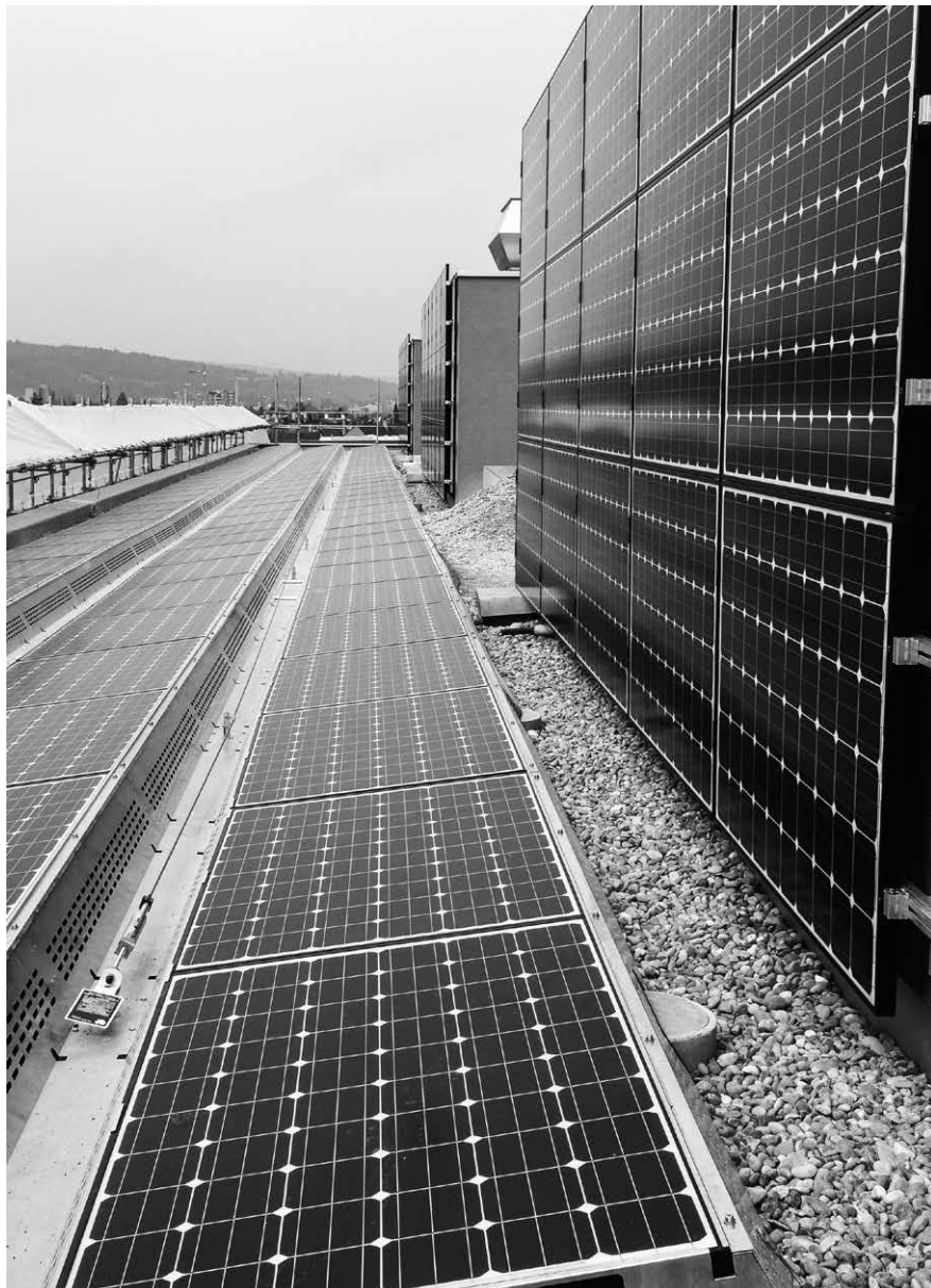
Solaranlage auf einem Flachdach der Siedlung Kalkbreite in Zürich. Für Solaranlagen auf Flachdächern braucht es eine Baubewilligung, ausser, die Kantone erklären sie für baubewilligungsfrei.
